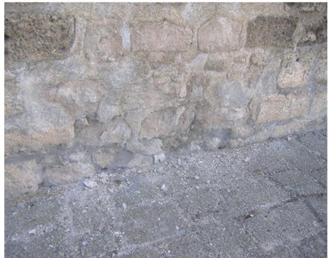
Restos de piedra desprendidos en el suelo
